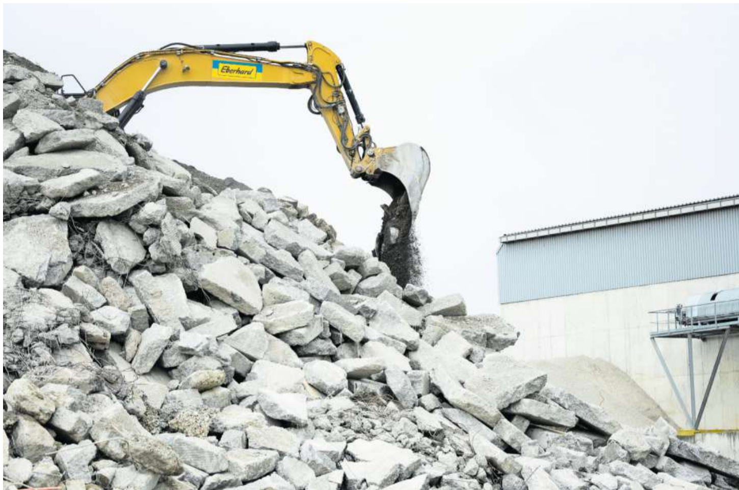
Ein Bagger schaufelt Beton-Abbruchteile auf einen Haufen. In der Kreislaufwirtschaft wird so neuer Baustoff aus vorhandener Bausubstanz gewonnen.
